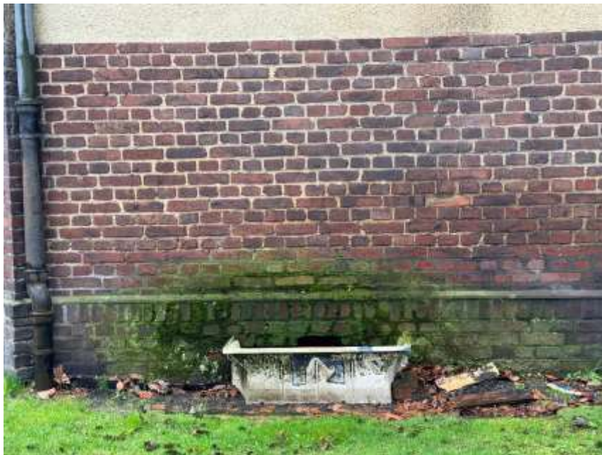
Bild 6: Schadensbild im Sockelbereich des Außenmauerwerks
