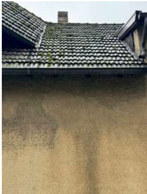
Bild 7: Fassade mit Schmutzfahnen
