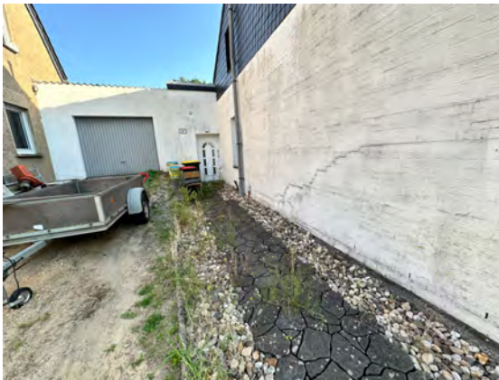
Seitlicher Zugang Wohnhaus mit Einfüllstutzen Heizöltank
