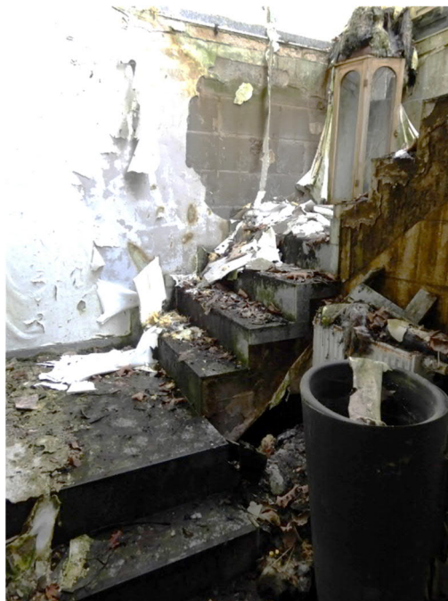
Brandruine Gebäude A, Treppe zum DG
