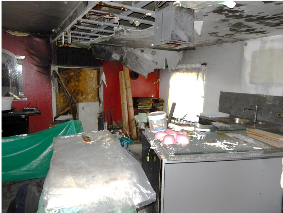
Brandruine Gebäude A, EG
