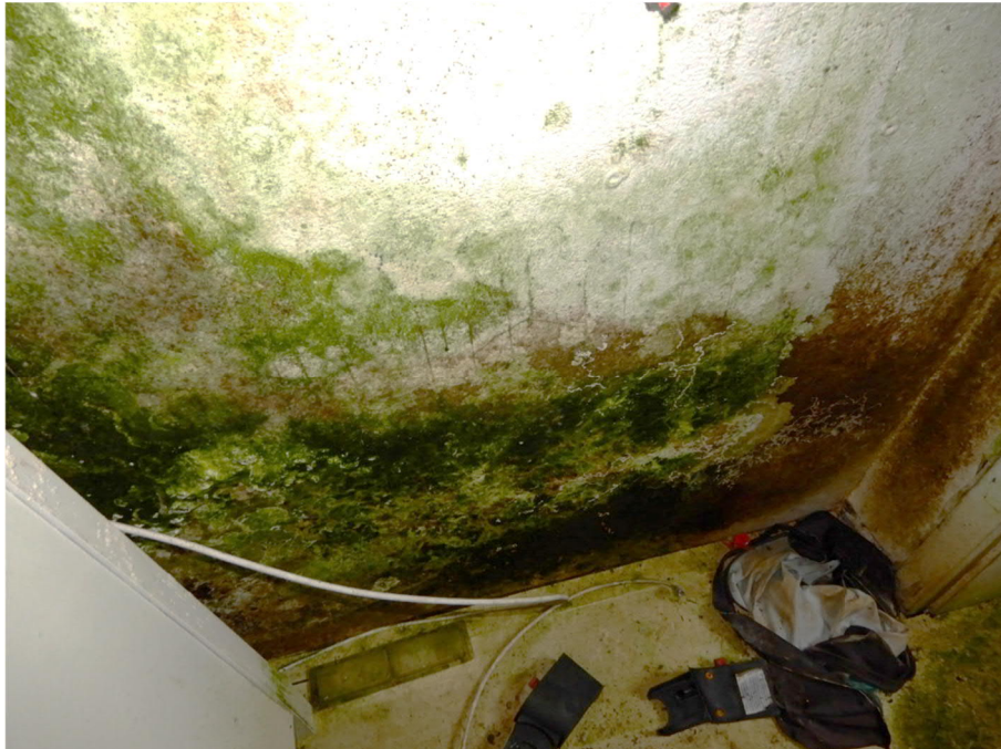
Schimmelschaden in Brandruine Gebäude A
