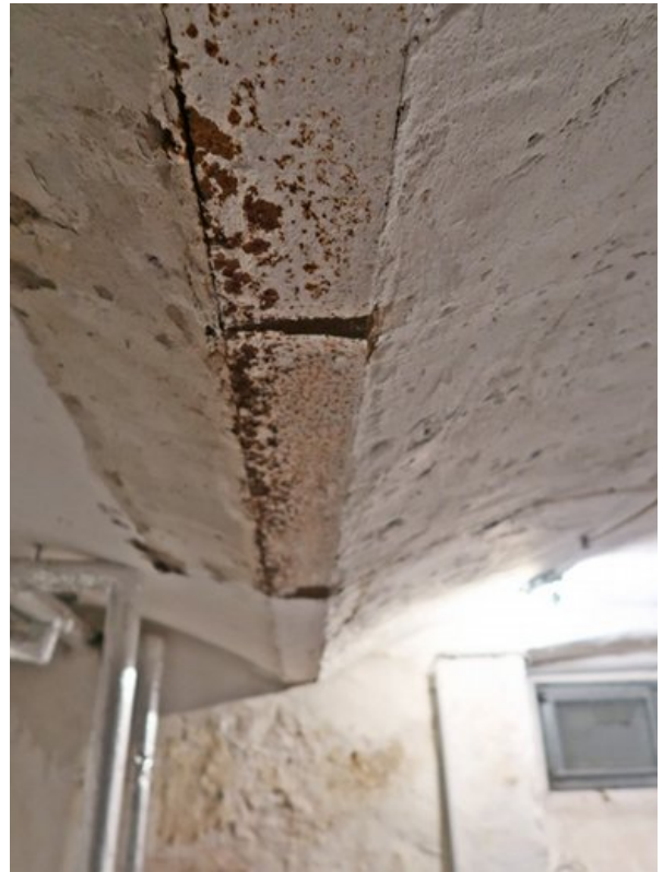
Decke Kellergeschoss: Träger der Kappendecke mit Korrosionsschäden
