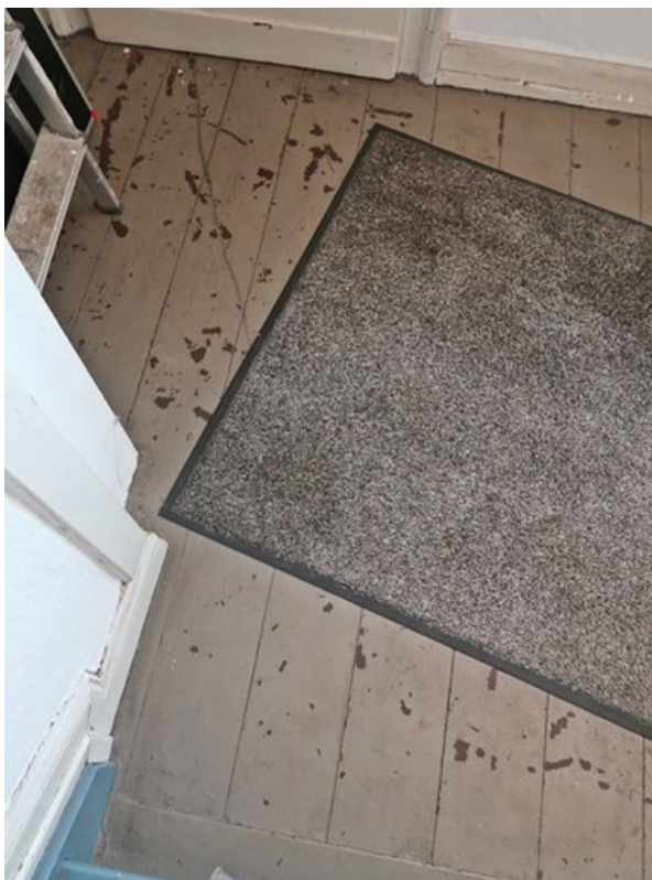
Podestfläche Treppenhaus mit Abplatzungen der Beschichtung
