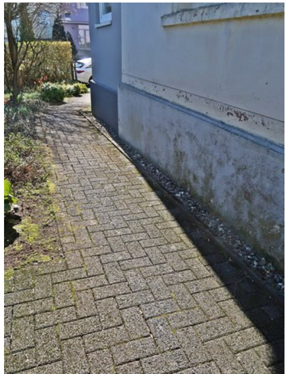
Verfärbungen am Sockelbereich der Giebelseite
