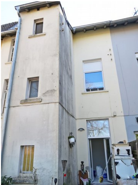
Verfärbungen an der rückseitigen Fassadenfläche
