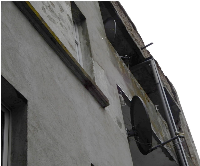
massive Fassadenschäden / nachträgliche Balkonabstützung
