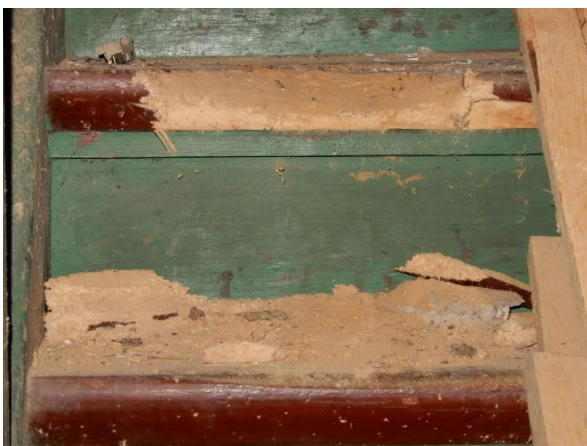
durch Holzschädling zerstörte Treppenstufen im Hinterhaus
