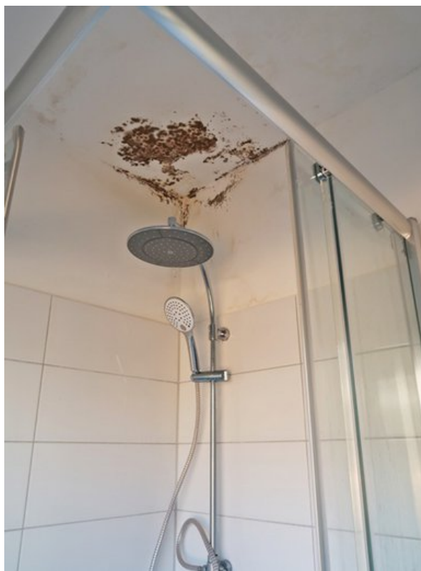
Feuchteschaden Decke Bad
