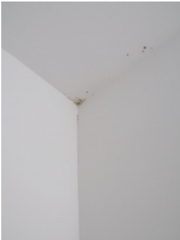
Feuchteanzeichen Decke Bad
