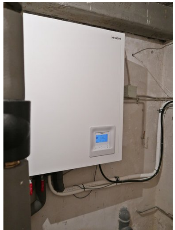
Inneneinheit der Wärmepumpe
