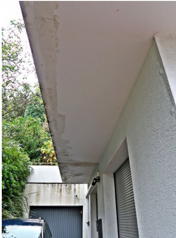
Untersicht Balkon 1. Untergeschoss mit Durchfeuchtungsschäden
