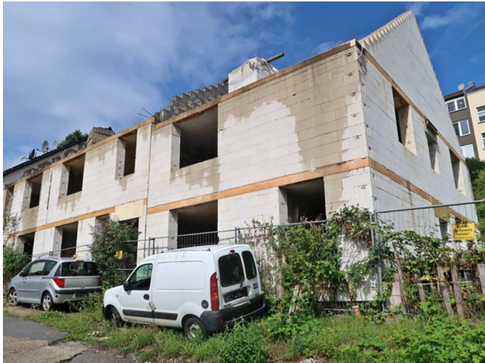
Ansicht Bebauung Flurstücke 307, 308 und 309, abbruchreif
