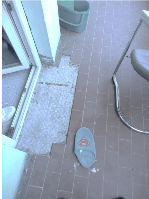
fehlende Balkonfliesen, beispielhaft
