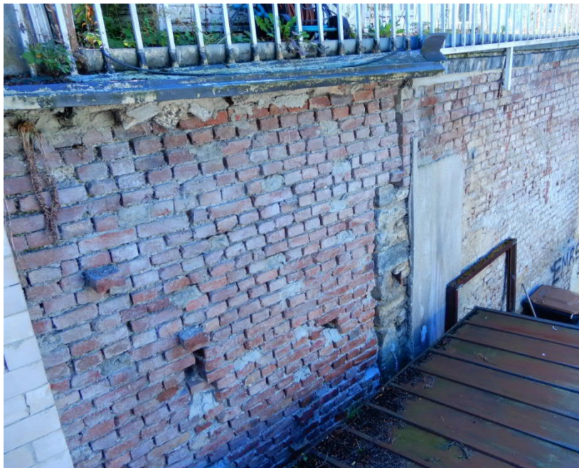
schadhafte Grenzmauer, beispielhaft
