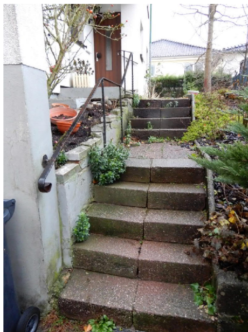
Zugangstreppe zur Haustüre
