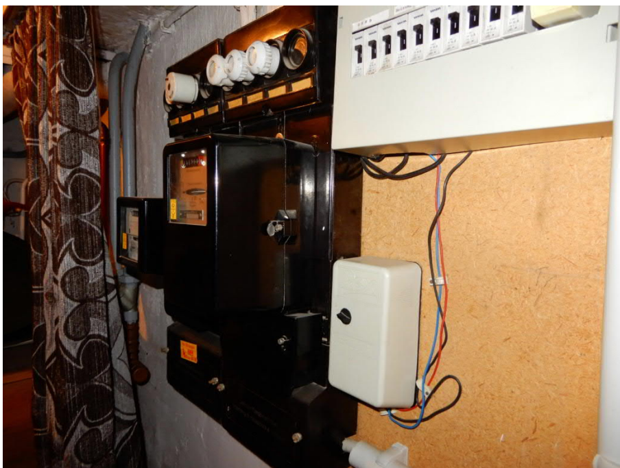
veraltete elektrische Anlage
