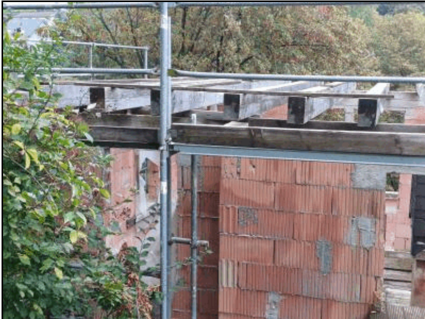
Foto 4: Dachbalken seit Jahren ungeschützt, unbrauchbar
