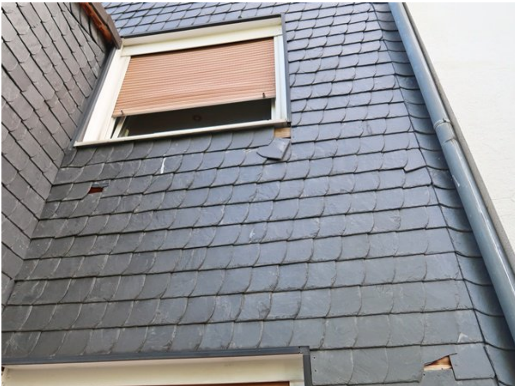
Rückseitige Fassadenfläche mit Fehlstellen in der Schieferbekleidung
