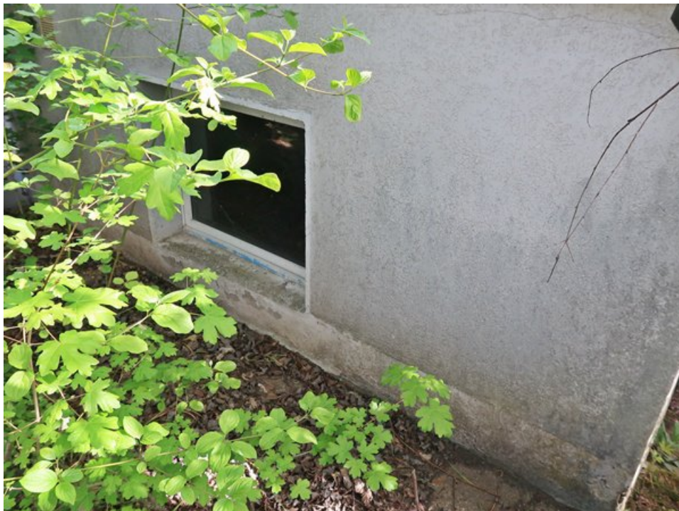
Teilansicht rückseitige Fassadenfläche des Anbaus mit Feuchteanzeichen und Putzschäden
