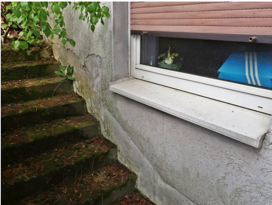
Teilansicht seitliche Fassadenfläche Anbau mit Feuchteanzeichen und großflächigen Putzschäden
