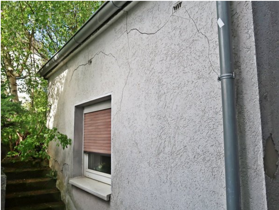
Seitenansicht rückseitiger Anbau mit Risssschäden
