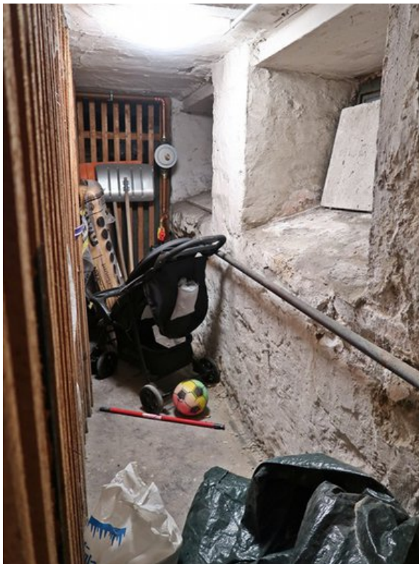
Flur mit Sperrmüllablagerungen
