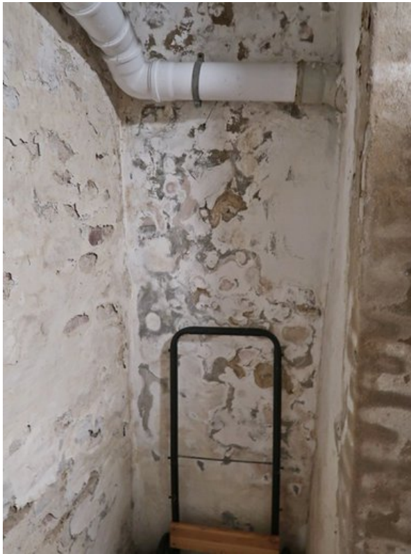
Teilansicht Wand Kellergeschoss mit Feuchteschäden und Putzabplatzungen
