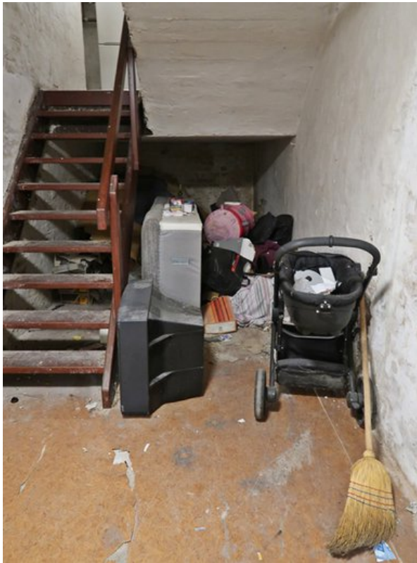
Treppe zum Kellergeschoss, Sperrmüllablagerungen
