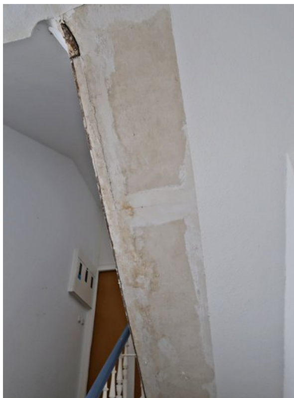
Teilansicht Untersicht Treppenlauf mit Instandsetzungsbedarf
