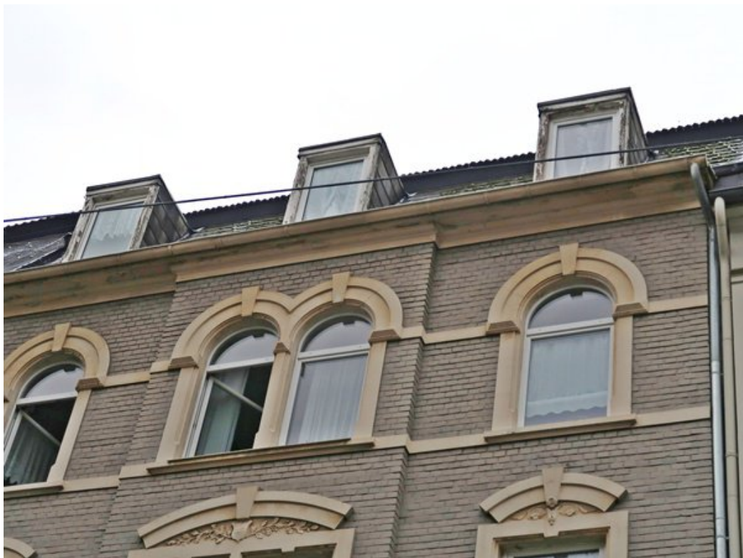
Teilansicht straßenseitige Dachfläche: Verwitterungsschäden an den Holzbauteilen der Gauben
