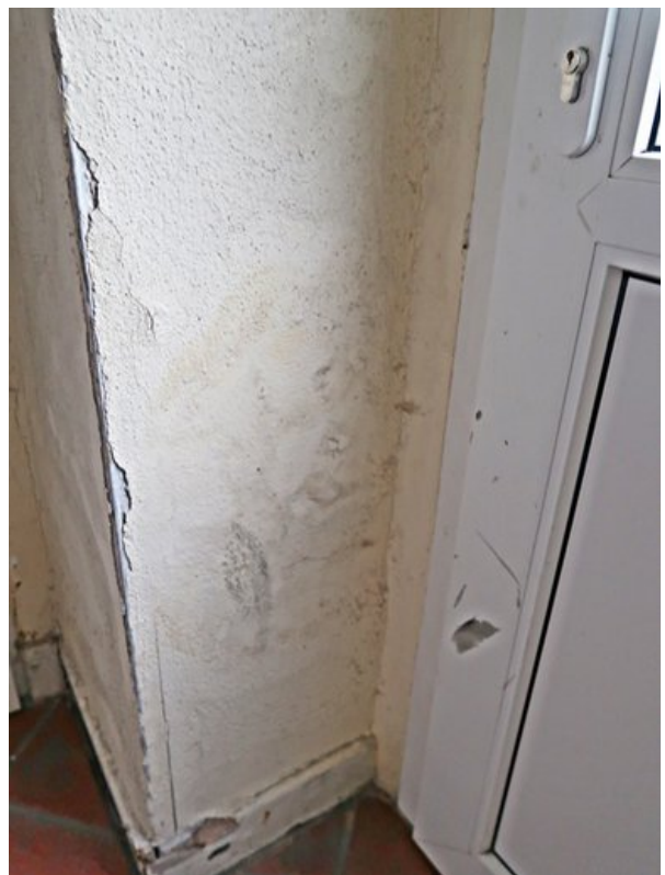
Treppenhaus: Feuchteschäden mit Abplatzungen im Bereich der Hofausgangstür
