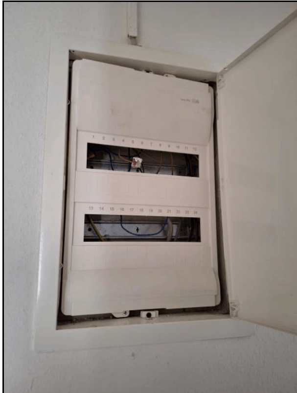
Foto 10: Beispiel Elektrik in den Wohnungen
