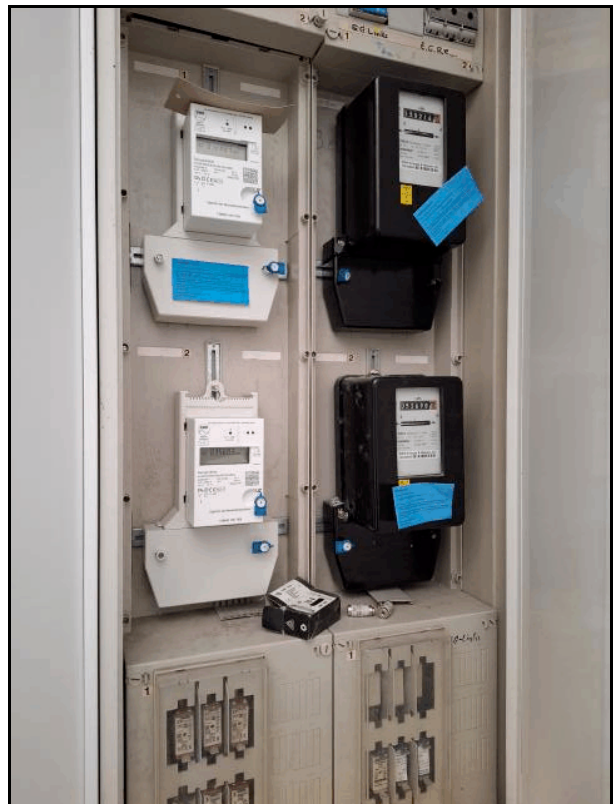
Foto 6: Elektroanschlüsse, alle gesperrt vom Energieversorger
