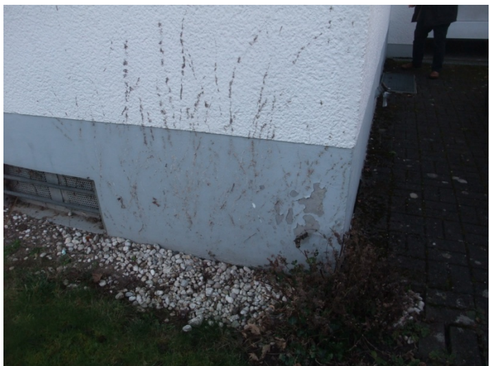
Fassadenverschmutzungen und -Putzabplatzungen
