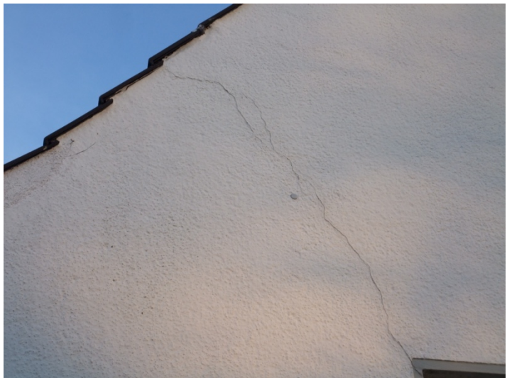
Rissbildungen an der Fassade
