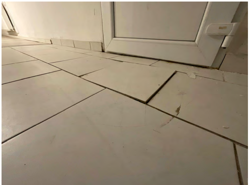
Lichtbild 14: Detail; Bodenfliesen im Kellergeschoss mit Verlegemängeln
