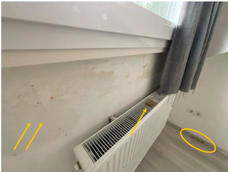
Lichtbild 15: Detail; Nässeinwirkung Dachgaube
