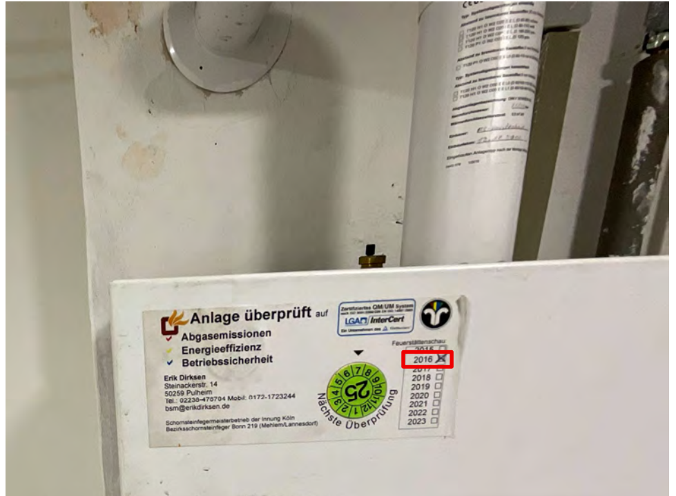
Lichtbild 17: Detail, Überprüfungsaufkleber auf der Heizungsanlage aus 2016
