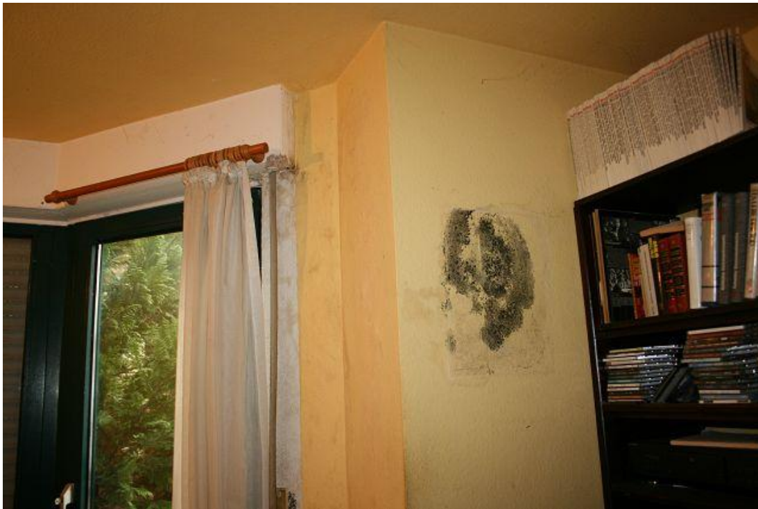
Bild 19 Reste eines Feuchteschadens im Wohnraum.
