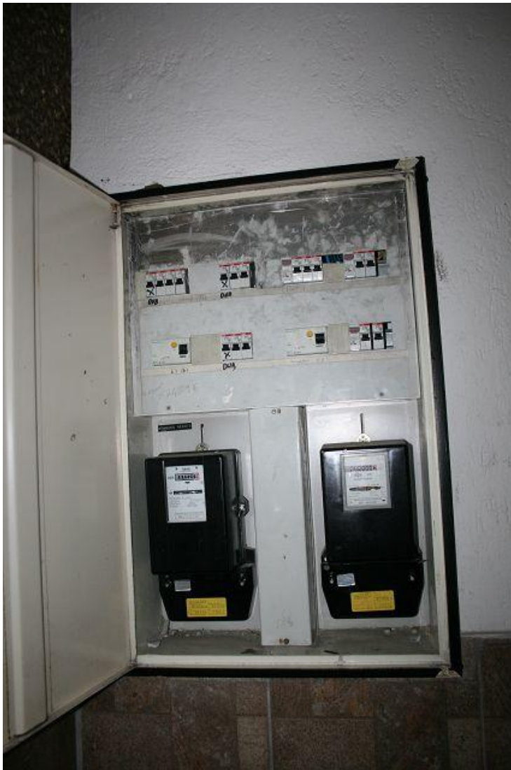
Bild 21 Elektroverteilung im 2. Obergeschoss.
