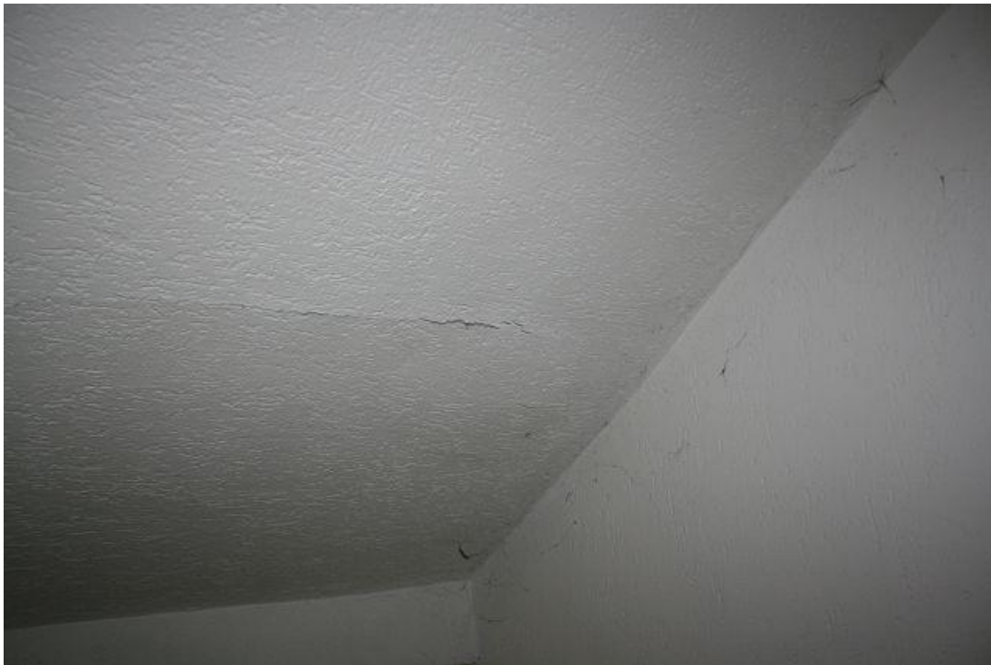
Bild 18 Diverse Rissbildungen im Treppenhaus.
