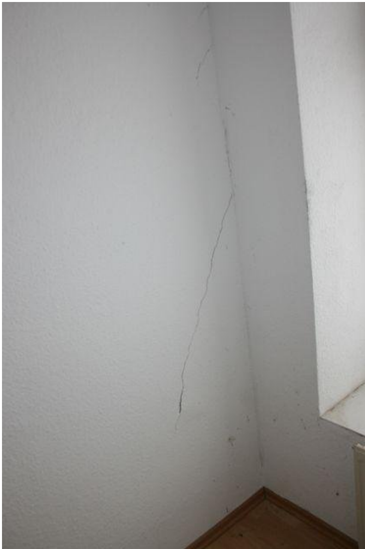
Bild 38 Wohnung Nr. 1, Detailaufnahme eines Wandrisses.
