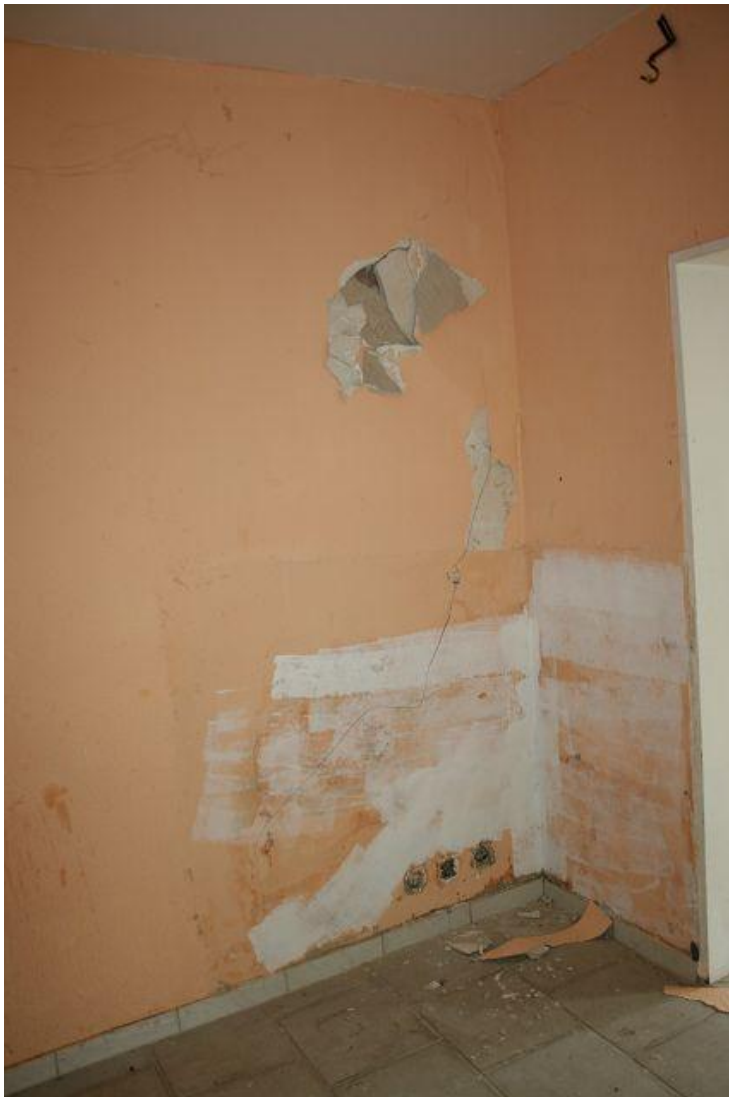
Bild 34 Wohnung Nr. 1, Schäden an den Wänden.
