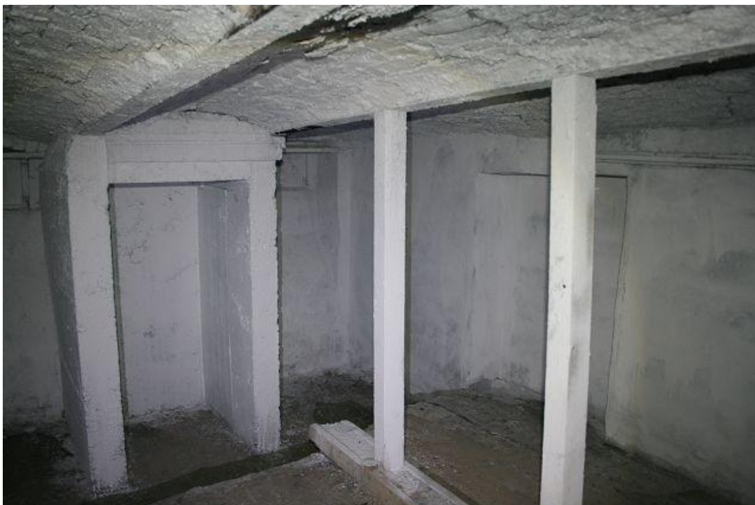
Bild 26 Kellerraum mit provisorischen Abstützungen.
