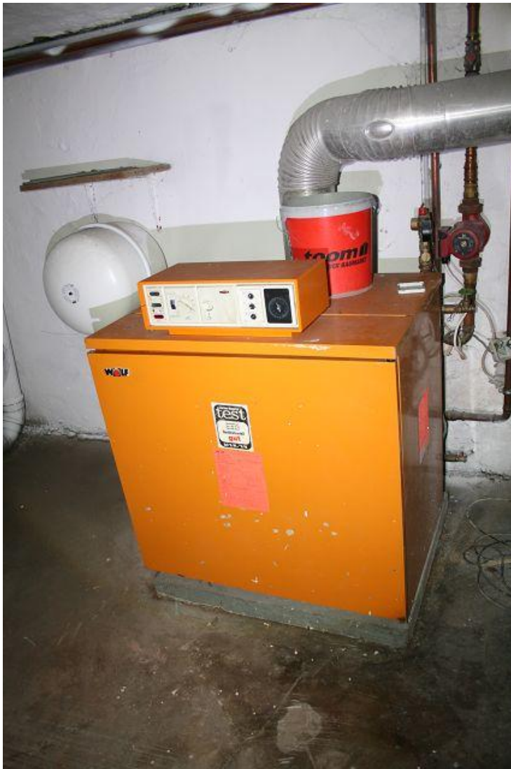
Bild 24 Die Heizungsanlage im Untergeschoss.
