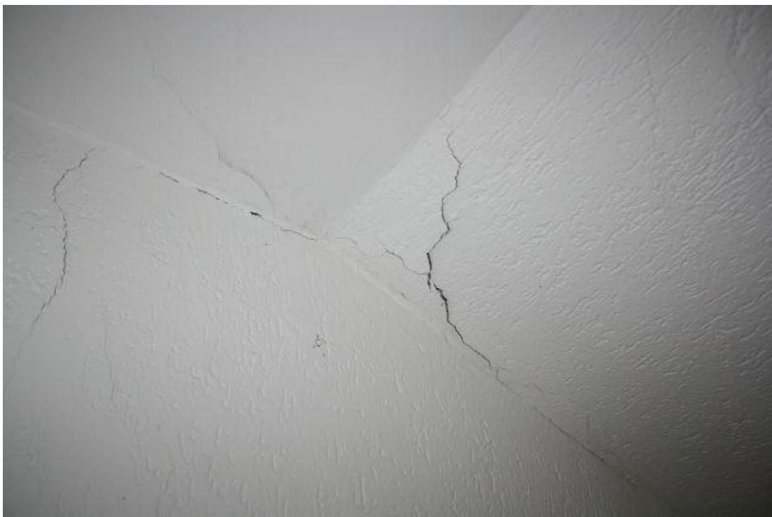
Bild 19 Diverse Rissbildungen im Treppenhaus.
