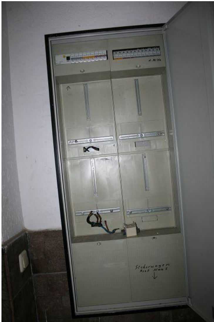
Bild 20 Fehlende Elektroinstallation zum Dachgeschoss.
