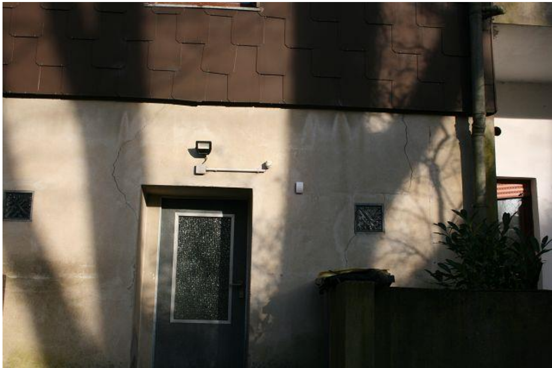
Bild 34 Rissbildungen in der rückwärtigen Fassade.
