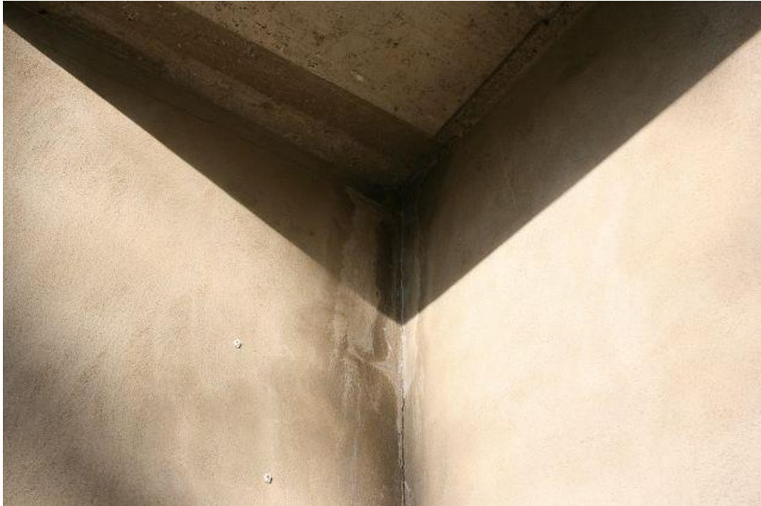
Bild 30 Detailaufnahme von Feuchteschäden am Balkon hinten rechts.
