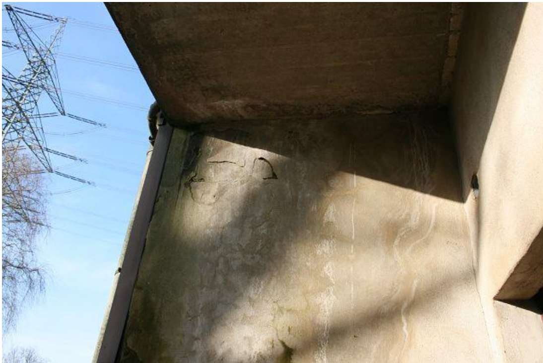
Bild 20 Detailaufnahme der Feuchteschäden.
