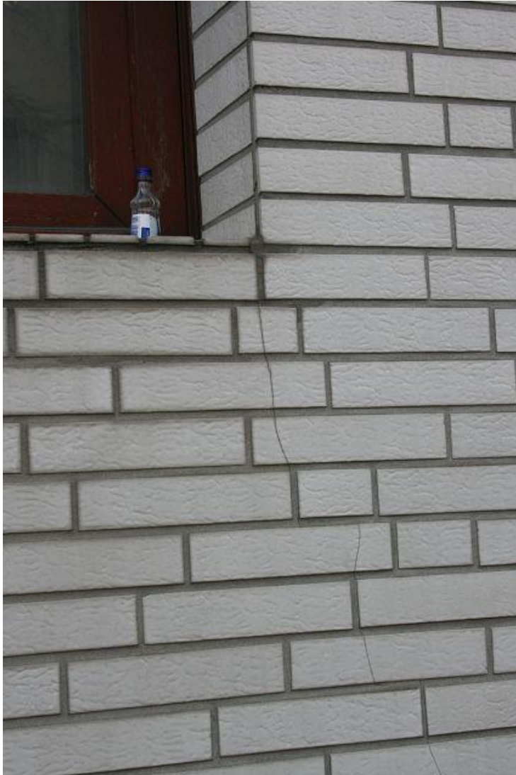
Bild 33 Rissbildungen in der straßenseitigen Fassade.
