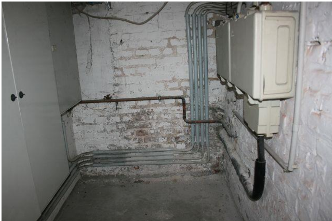
Bild 11 Die Elektroverteilung im Kellergeschoss.
