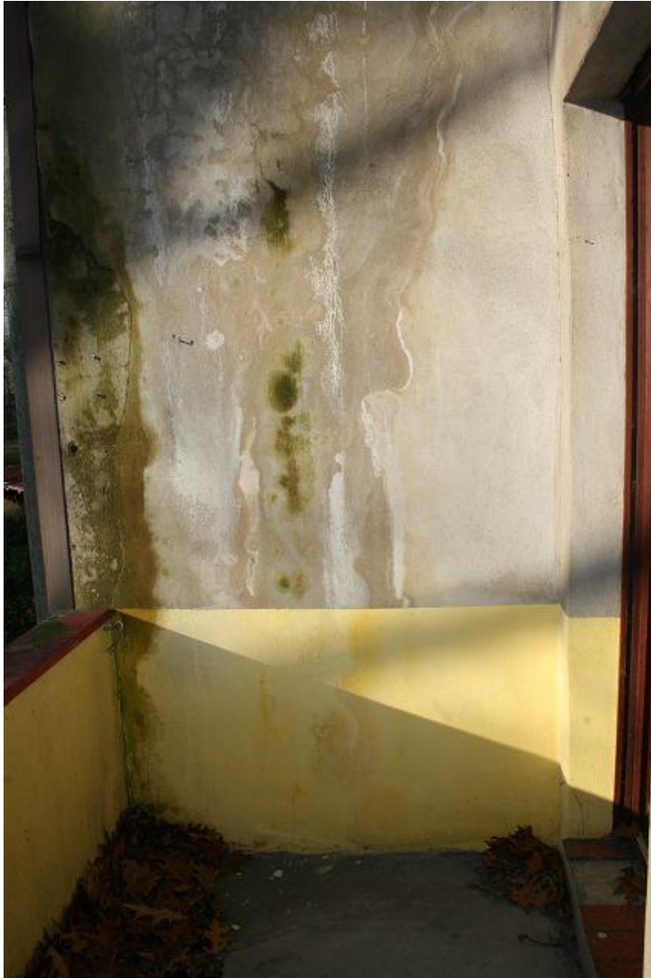
Bild 19 Balkon hinten links mit deutlichen Feuchteschäden.
