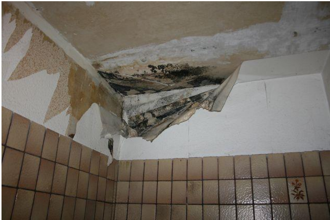
Bild 22 Detailaufnahme der Feuchteschäden im WC-Raum.
