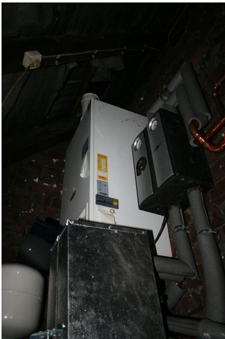
Bild 8 Die Heizungsanlage im Spitzboden.
