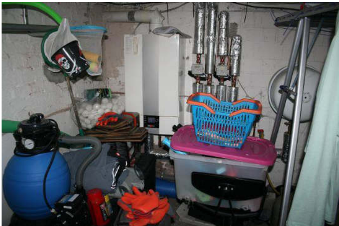
Bild 13 Die Heizungsanlage in der Waschküche.
