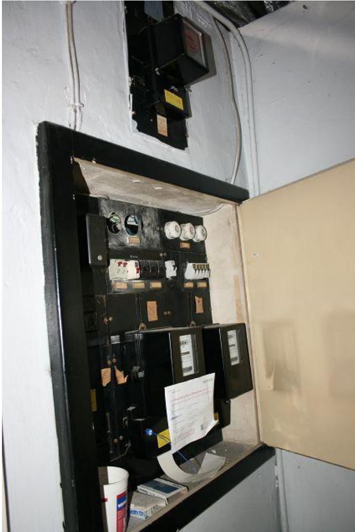
Bild 11 Die Elektroverteilung im Dachgeschoss.
