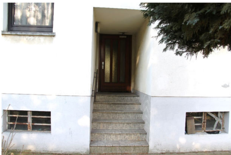
Bild 7 Gartenausgang Rostschäden an den Kellerfenstern, tlw. defekt
