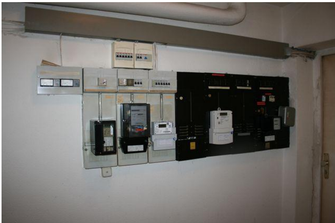
Bild 11 Die Elektroverteilung im Untergeschoss.
