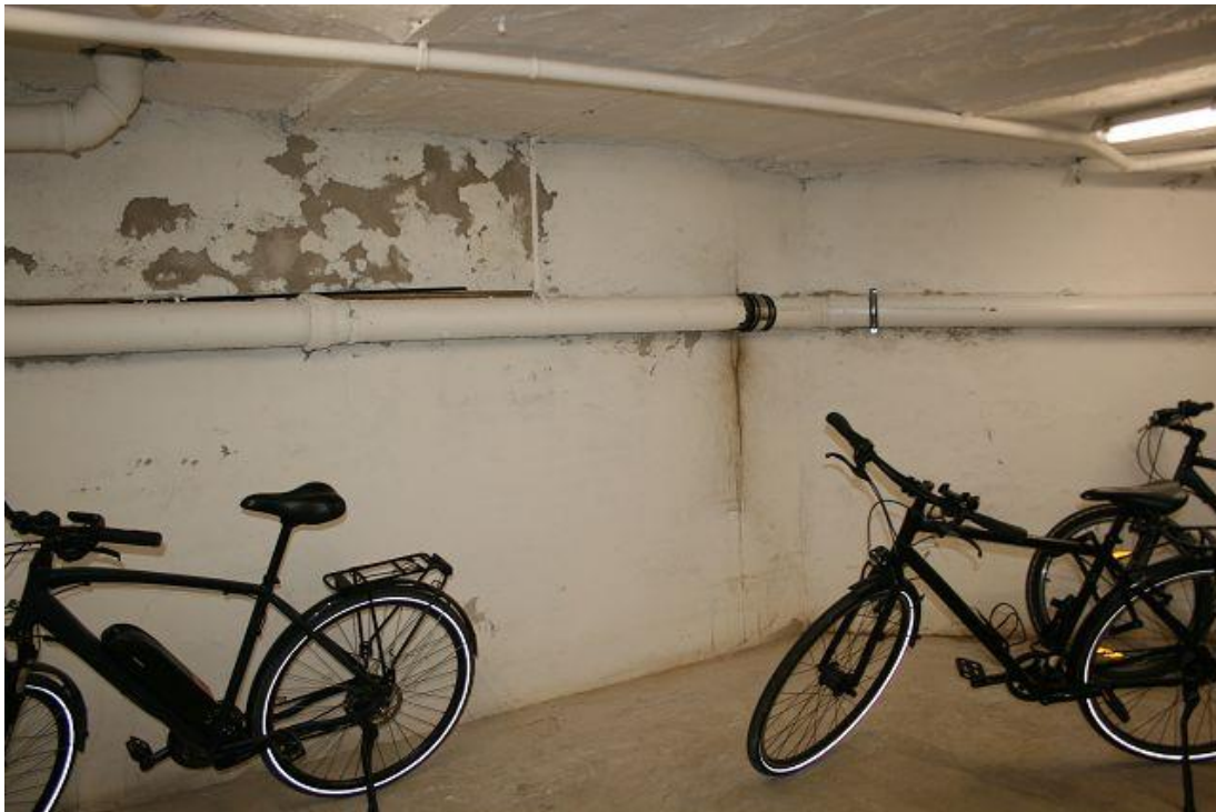
Bild 12 Deutliche Feuchteschäden im Gemeinschaftsraum im Kellergeschoss.
