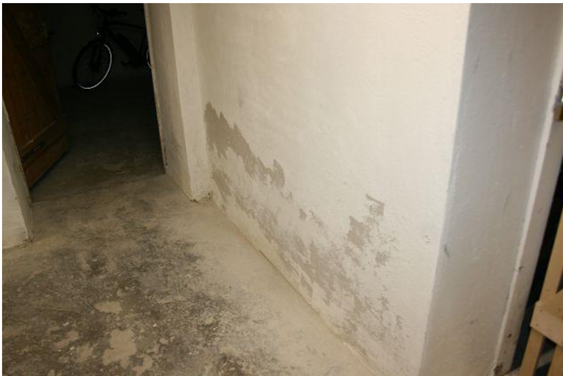
Bild 13 Detailaufnahme weiterer Feuchteschäden.
