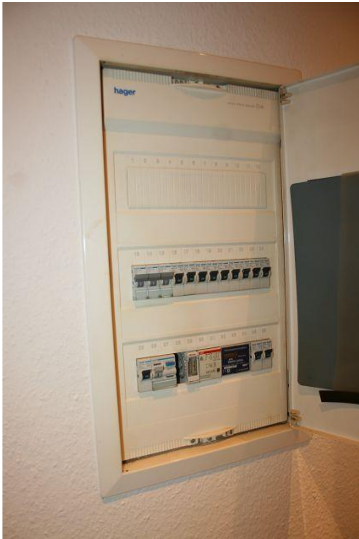
Bild 19 Die Elektroverteilung der Wohnung.
