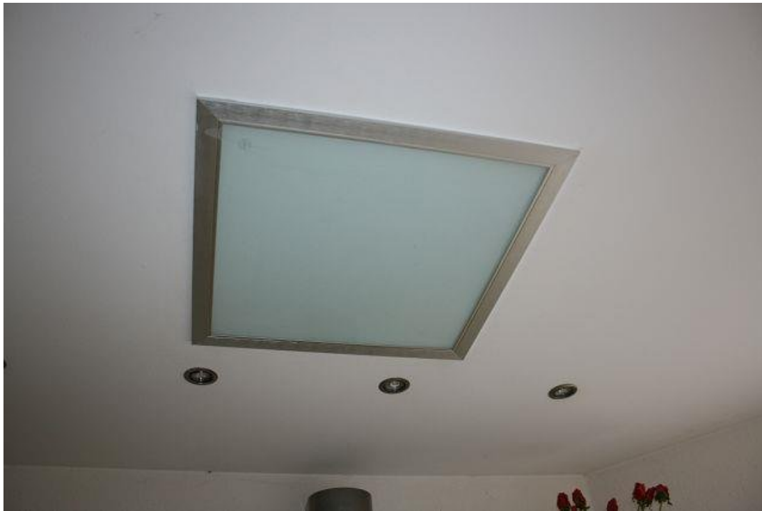
Bild 17 Beheizung über Infrarotdeckenstrahler.
