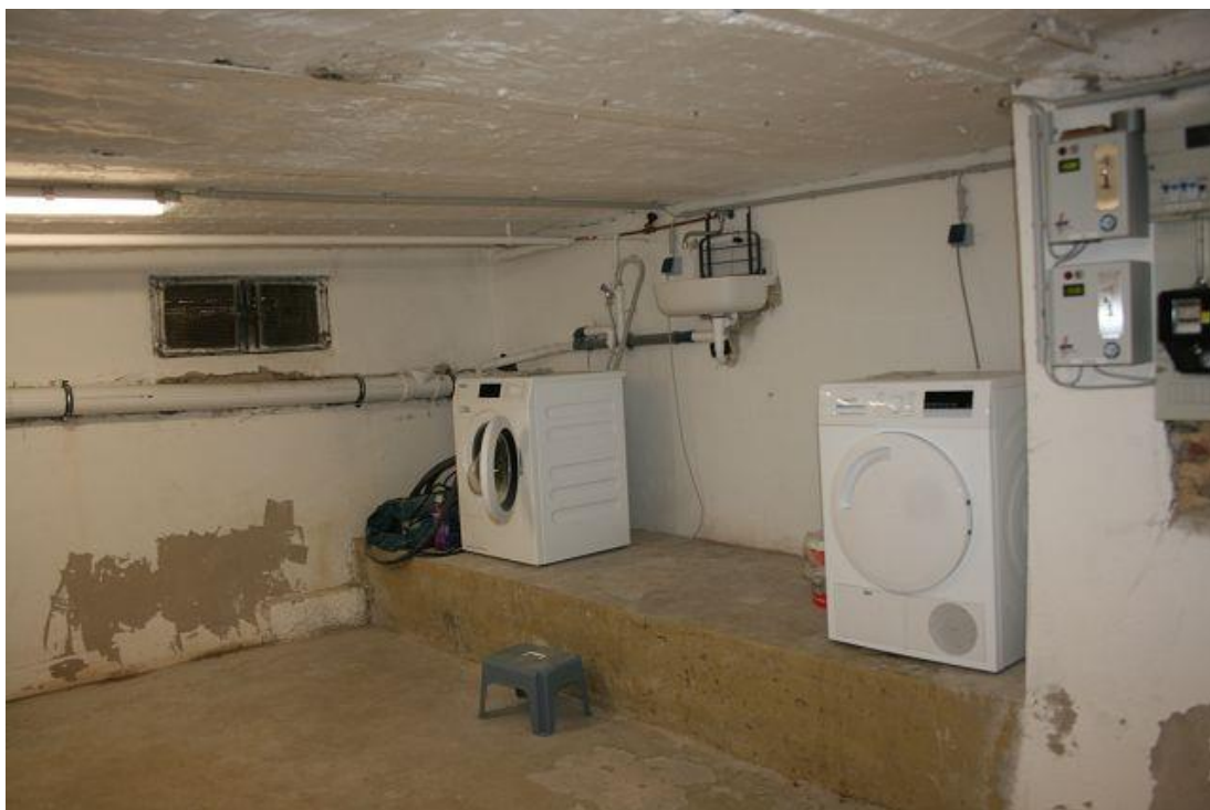
Bild 11 Gemeinschaftswasch- und Trockenraum im Kellergeschoss.
