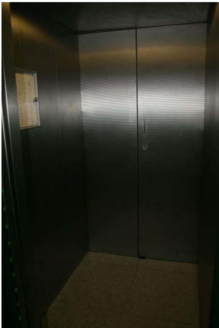
Bild 12 Innenansicht eines Aufzugs.
