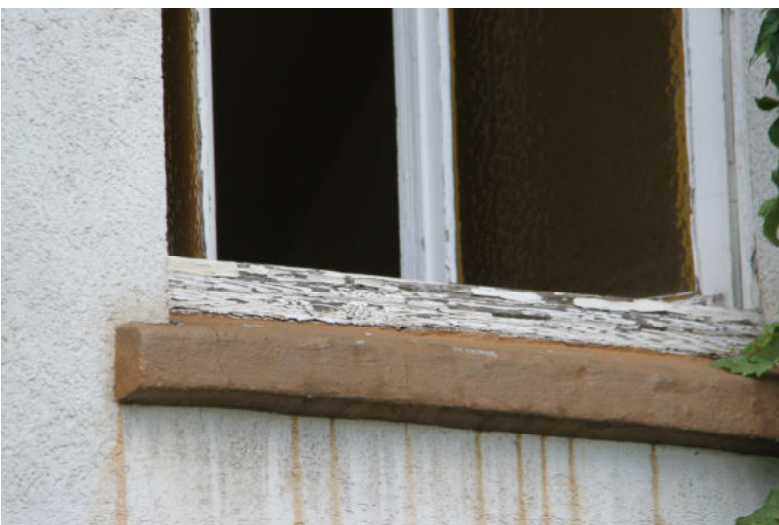
Bild 10 Treppenhausfenster, Holzfenster, einfachverglast (erneuerungsbedürftig)
