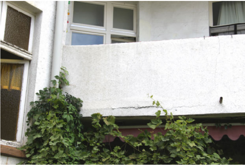
Bild 8 wie vor, Putzschäden im Bereich der Balkone
