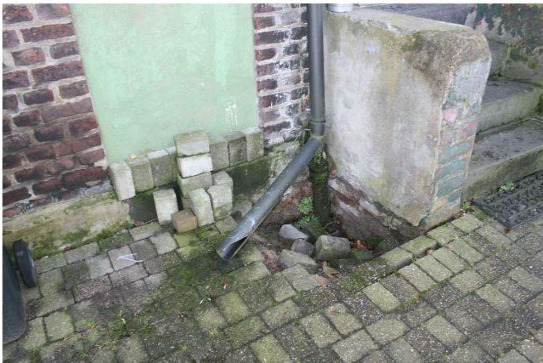
Bild 6 Teilweise defekte Dachentwässerung.
