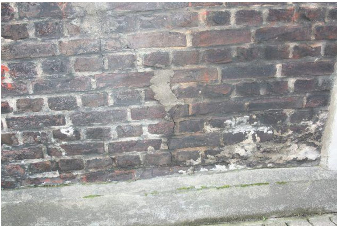
Bild 8 Detailaufnahme eines weiteren Fassadenrisses.
