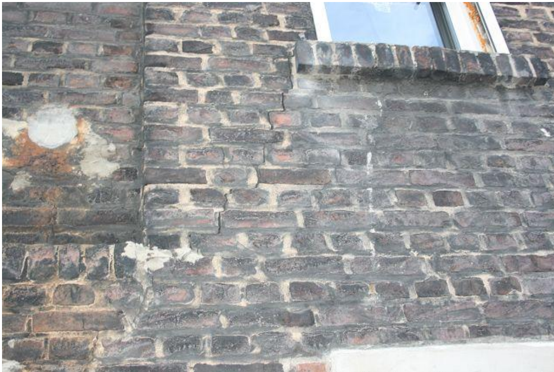
Bild 7 Detailaufnahme eines Fassadenrisses.
