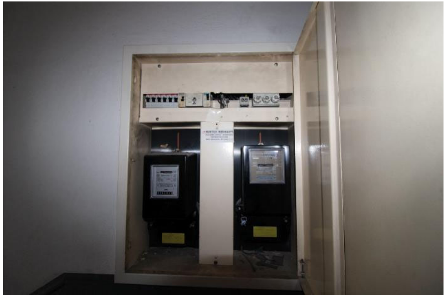
Sicht vom Treppenhaus aus auf die Elektrounterverteilungen und Stromzähler / EG
