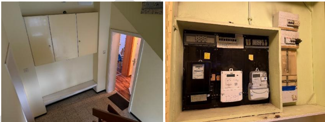
Wohnungseingangsbereich und Elektrounterverteilung
