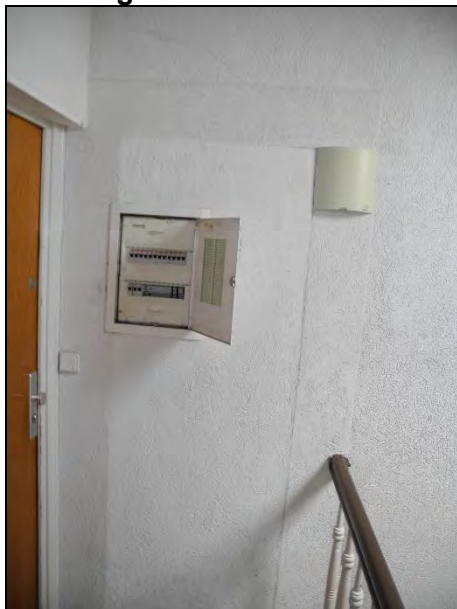
Elektroverteilung / verschlossene Tür
