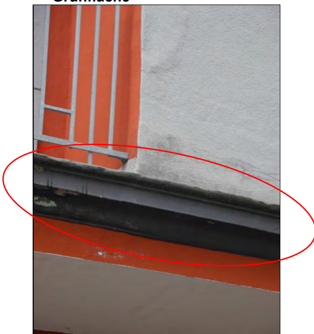
Fassade Erker / Mängel
