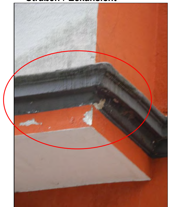
Fassade Erker / Mängel
