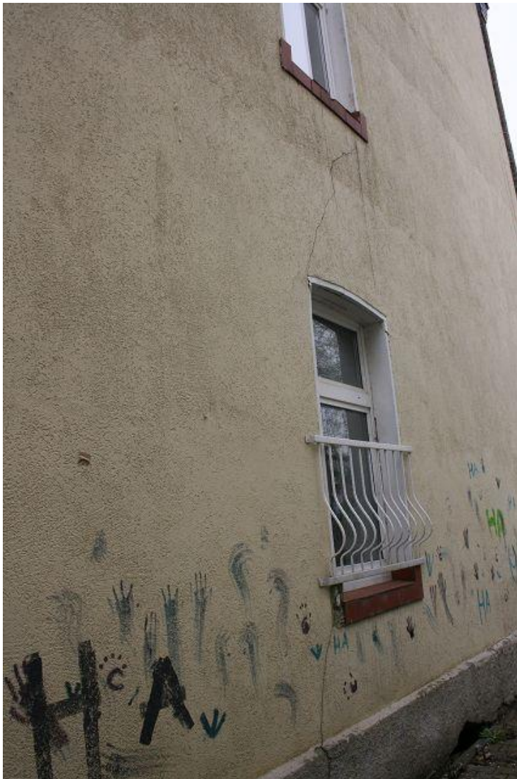
Bild 4 Giebelfassade mit deutlicher Rissbildung.
