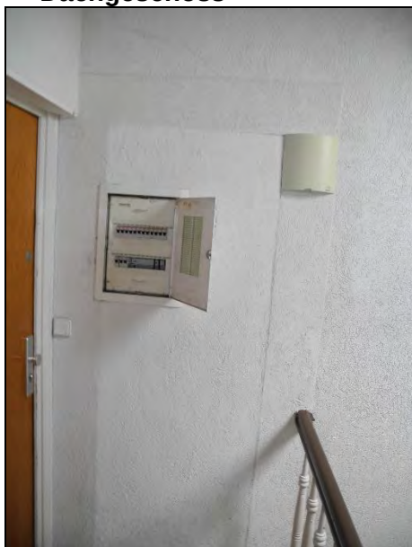
Elektroverteilung / verschlossene Tür
