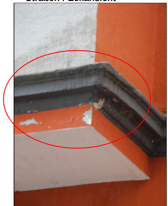
Fassade Erker / Mängel
