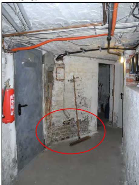
Kellerflur / Mängel Feuchtigkeit
