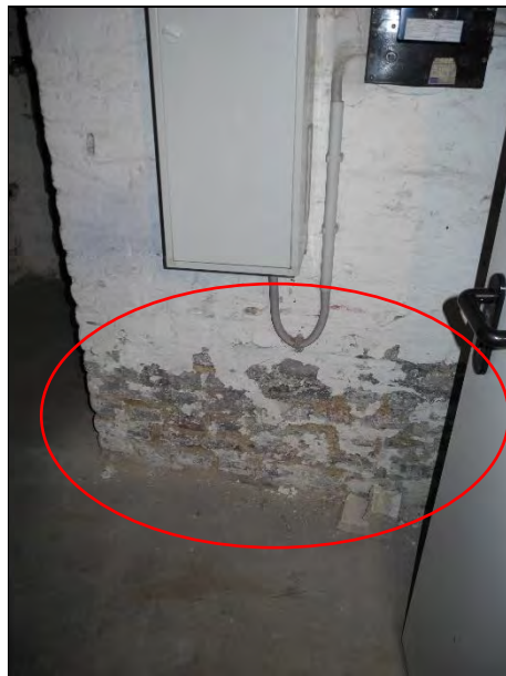
Keller / Mängel Feuchtigkeit
