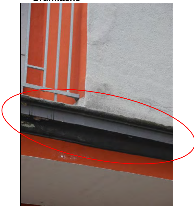
Fassade Erker / Mängel
