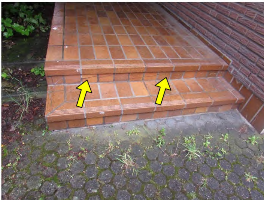
Foto 4: Eingangspodest, gerissene Fliesen
