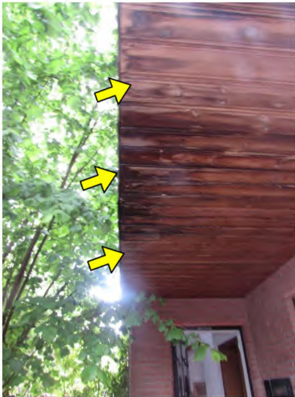
Foto 3: Unteransicht der Loggia, Feuchtigkeitsschaden an der Holzverkleidung
