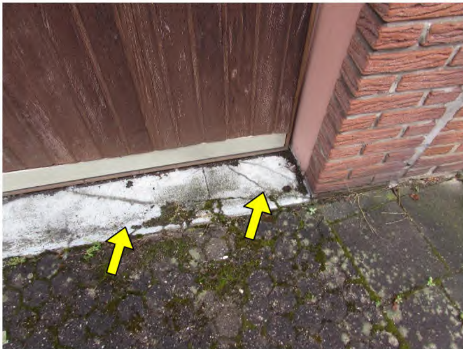
Foto 8: PKW-Doppelgarage, gerissener Betonboden im Zufahrtsbereich
