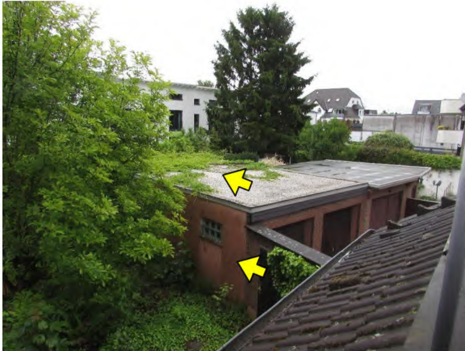
Foto 7: PKW-Doppelgaragendach mit Bewuchs, fleckige Putzfassade
