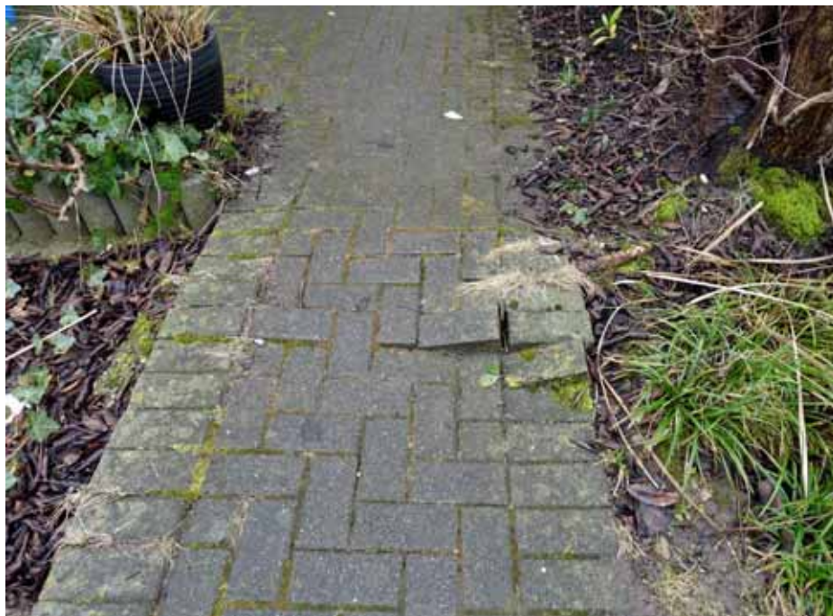
beschädigter Bodenbelag der Zuwegung
