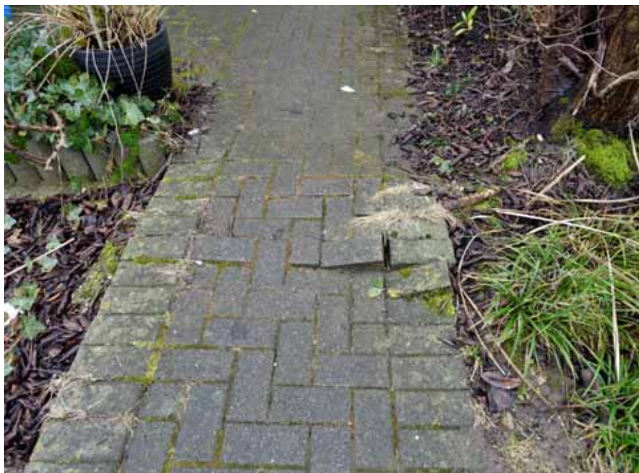
beschädigter Bodenbelag der Zuwegung
