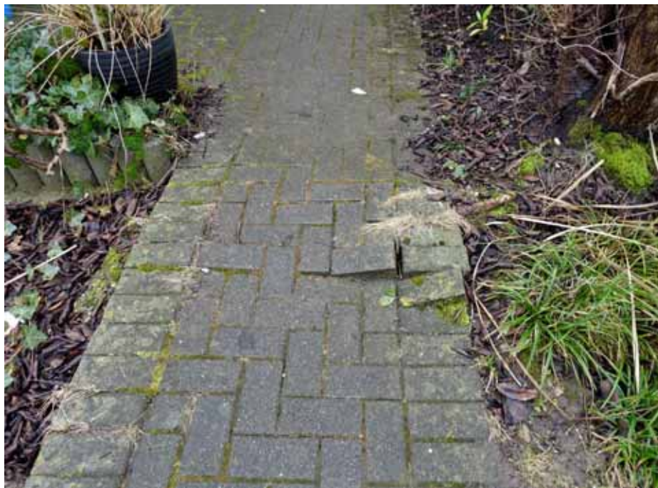
beschädigter Bodenbelag der Zuwegung
