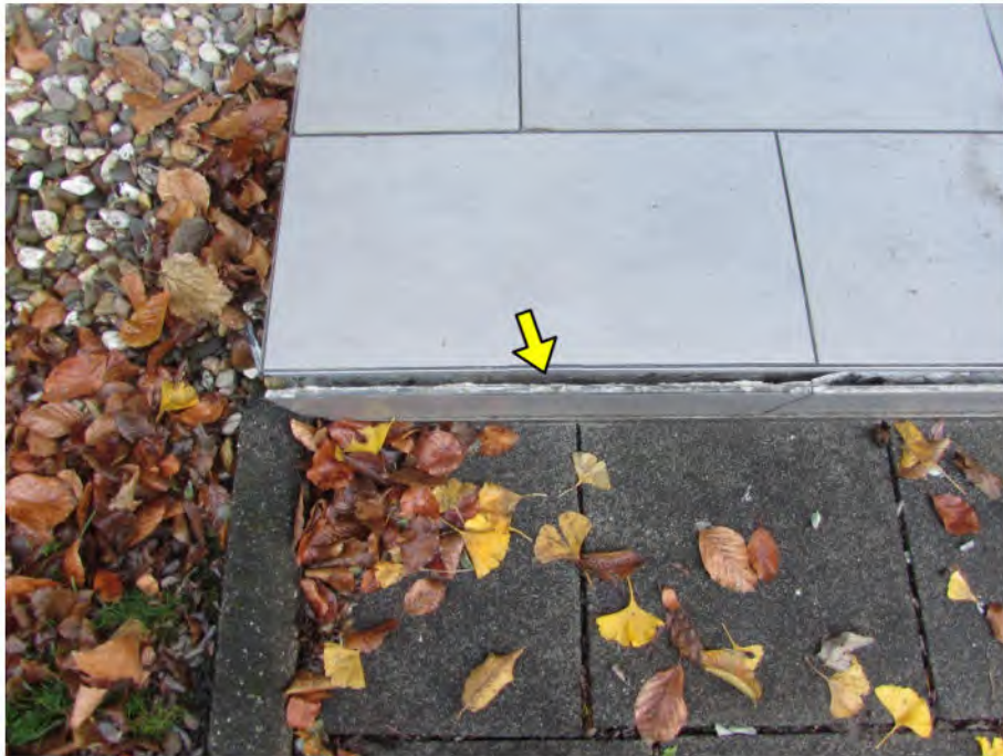
Foto 3: Hauseingang: schadhaftes Eingangspodest
