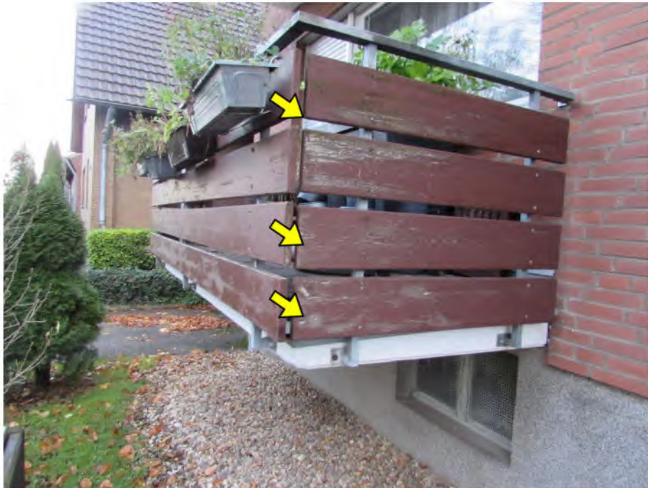
Foto 5: Balkon: tlw. verwitterte Geländerverkleidung
