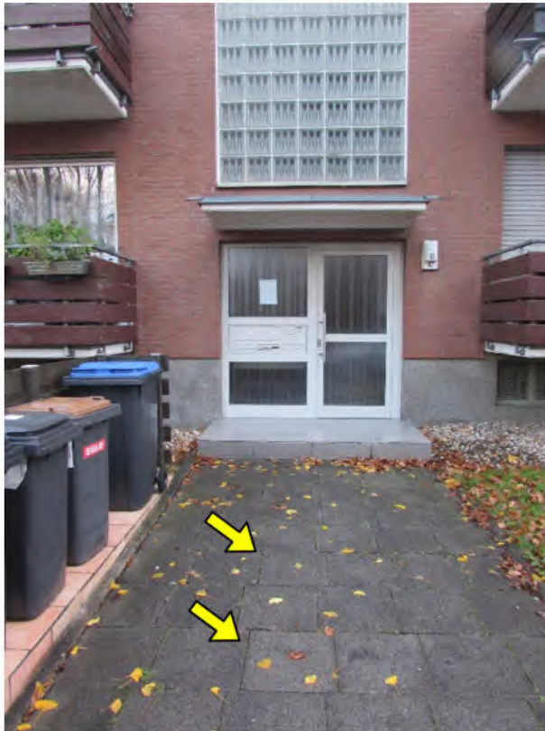
Foto 7: Zugang: tlw. abgesetzte Betonplattenbefestigung
