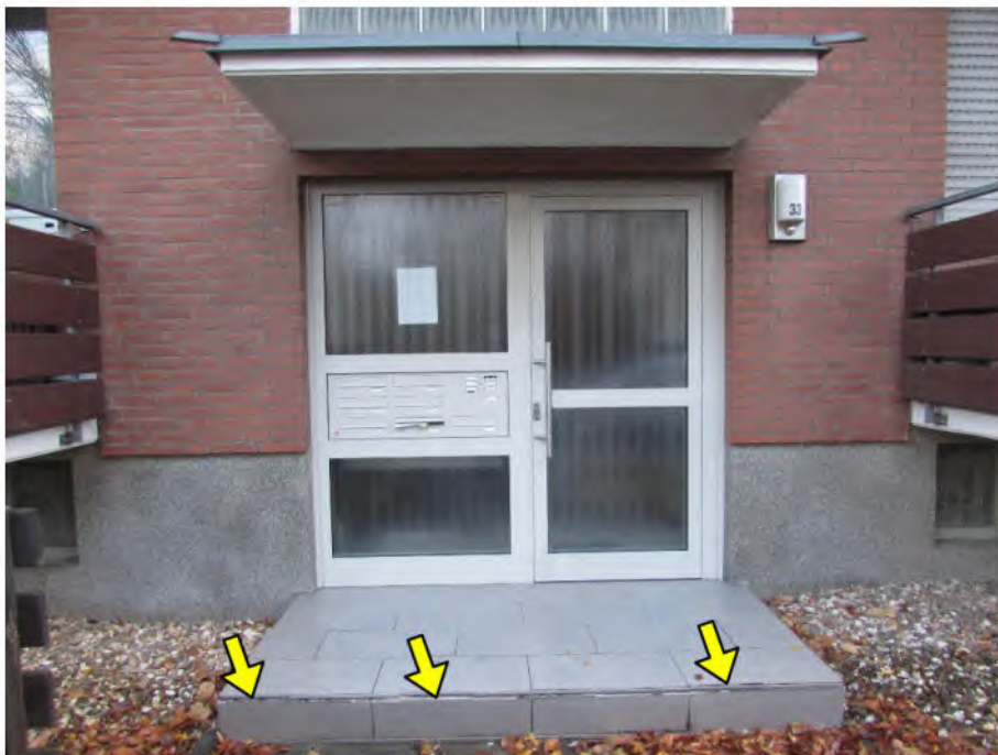
Foto 2: Hauseingang: schadhaftes Eingangspodest
