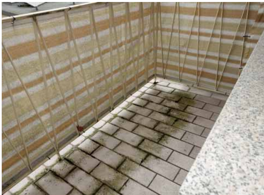
beschädigter Bodenbelag des Balkons
