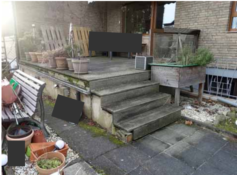
beschädigte Terrasse sowie Terrassentreppe
