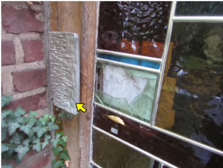
Foto 4: Hauseingang: überalterte, verwitterte Holztür, beschädigte Glasfüllung
