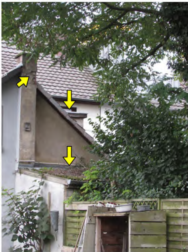
Foto 6: rückwärtige Ansicht, Schuppen und Wohnhaus-Anbau: Putzabplatzungen im Schornsteinbereich
