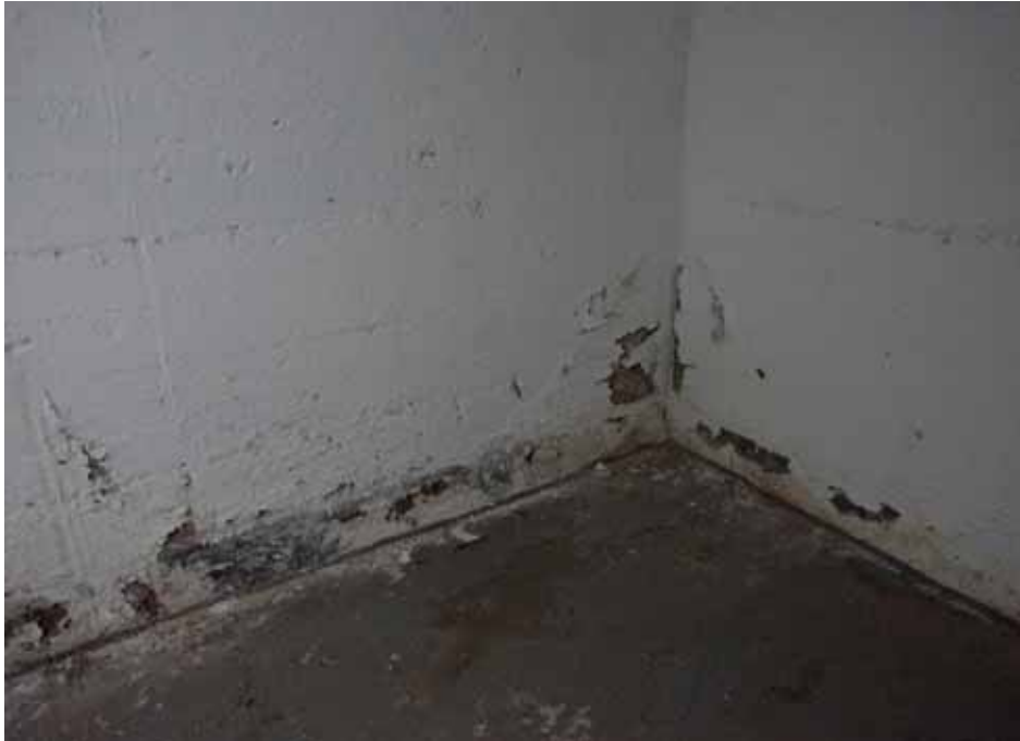
Feuchtigkeitsschäden im Kellergeschoss
