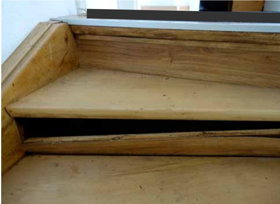
beschädigte Stufe der zum Obergeschoss führenden Holztreppe
