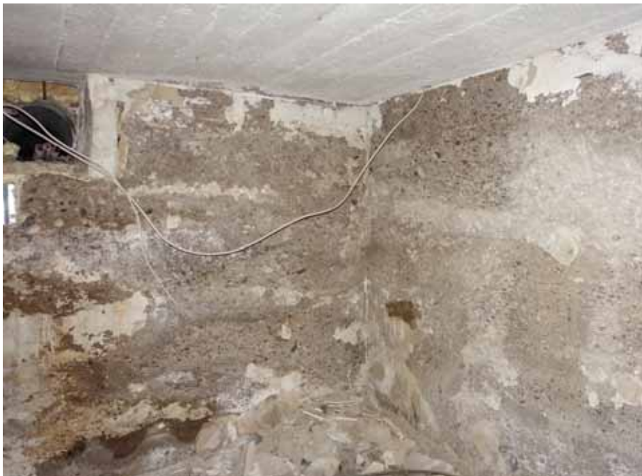
Feuchtigkeitsschäden im Bereich der Kellerwände
