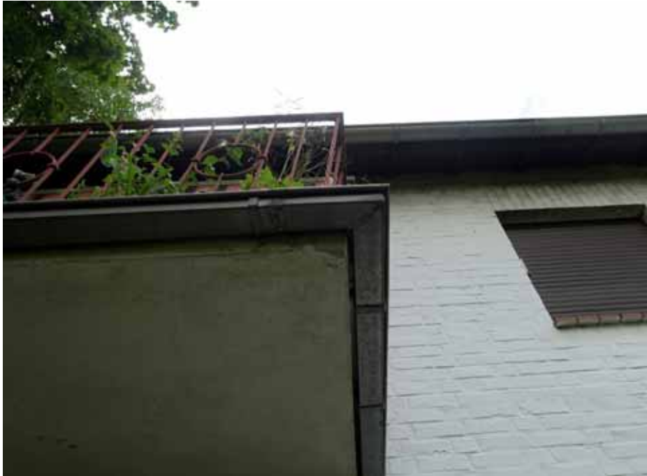
unterseitig stellenweise beschädigte Balkonplatte
