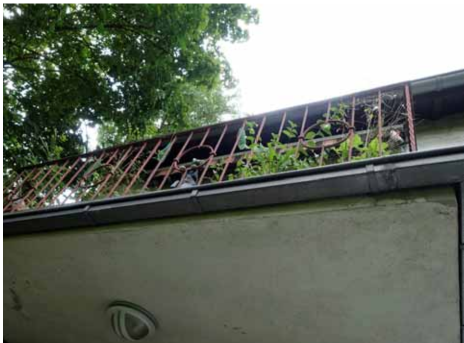
unterseitig stellenweise beschädigte Balkonplatte
