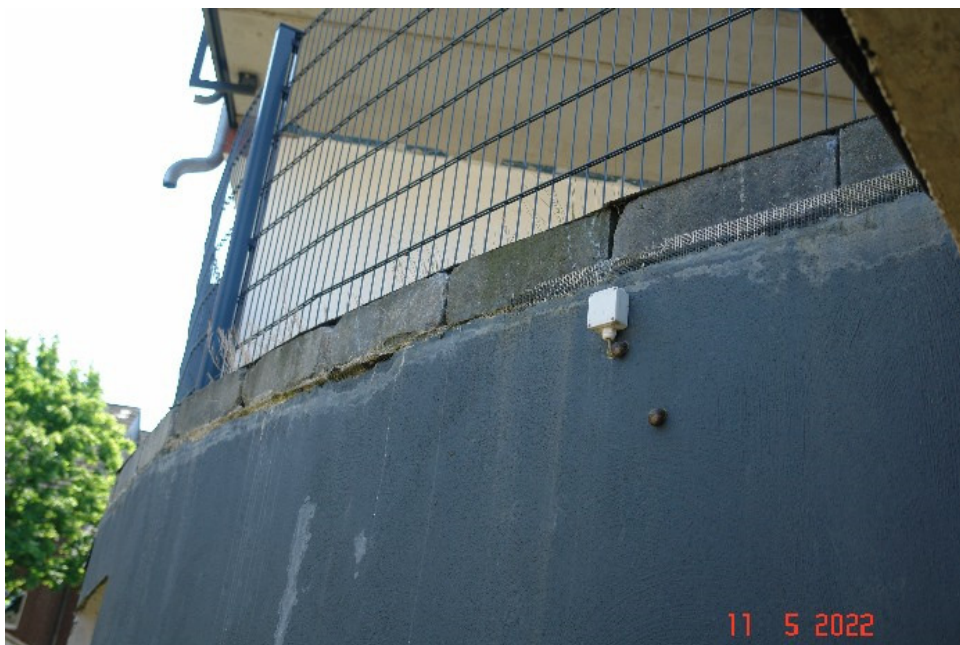
Bild 12: Leichte Feuchtigkeitsschäden im Bereich der TG-Zufahrt
