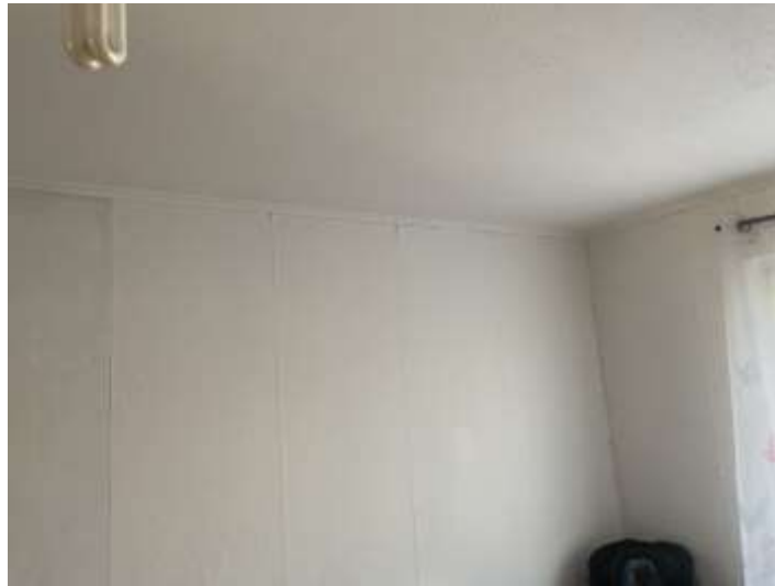
Bild 17: Unfachmännisch ausgeführte Tapezierarbeiten
