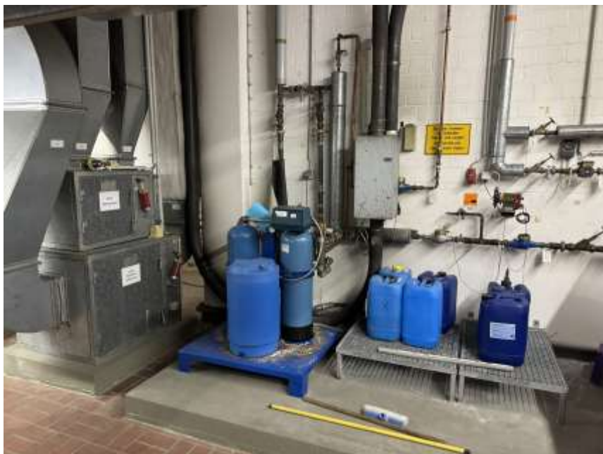
Bild 14: Heizungs- und Technikraum
