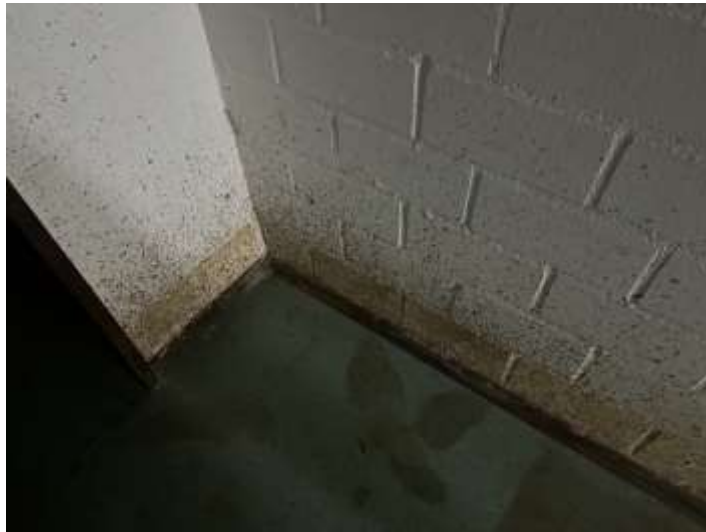
Bild 19: KG: Schadensbild (zurückliegender Wasserschaden)
