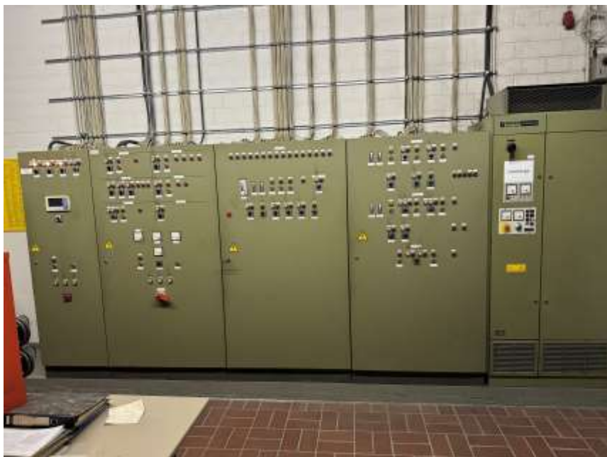
Bild 12: Heizungs- und Technikraum
