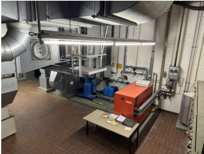
Bild 11: Heizungs- und Technikraum
