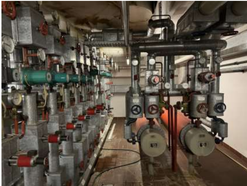
Bild 13: Heizungs- und Technikraum
